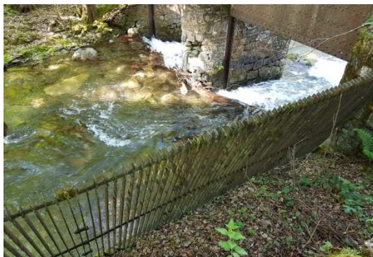
Imatge 05. Estat Actual reixa de la captació.
