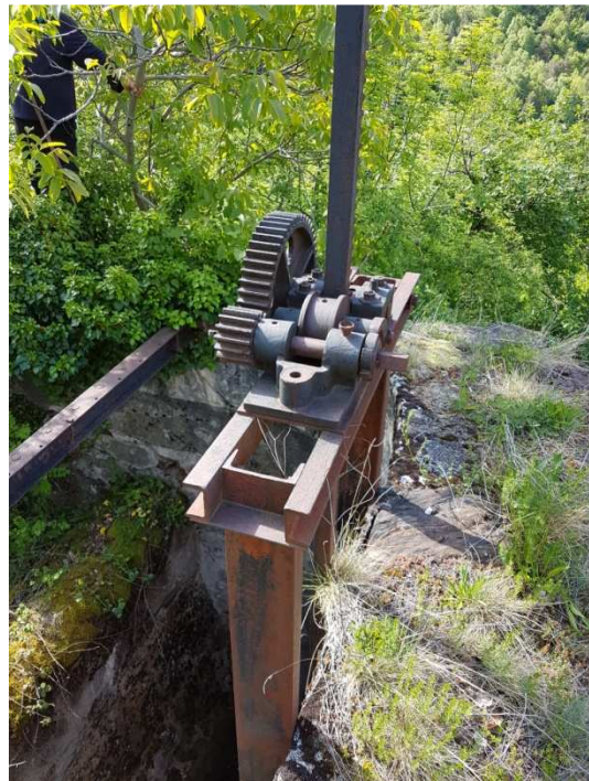
Imatge 28. Estat Actual comporta de la càmera de carga.
