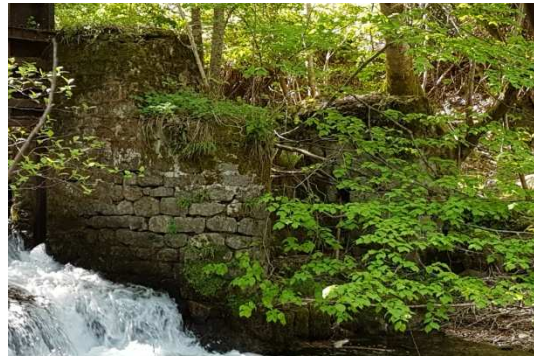
Imatge 09. Estat Actual sobreixidor captació aigües avall.
