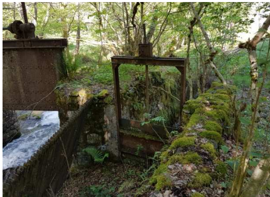
Imatge 03. Estat Actual comporta de la captació.
