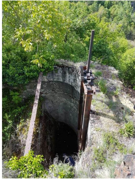
Imatge 26. Estat Actual comporta de la càmera de carga.
